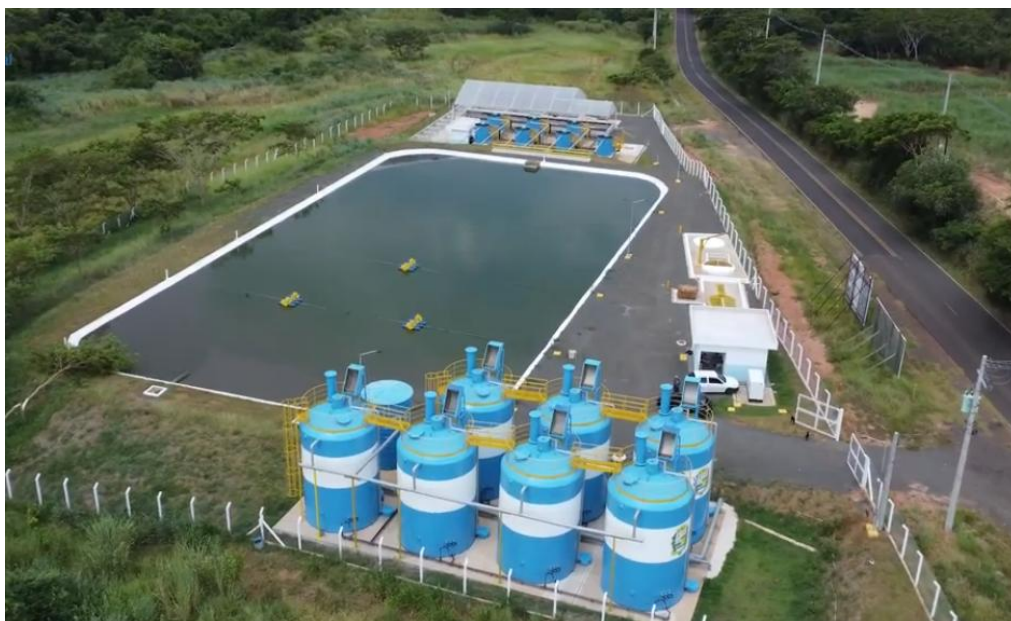
Figura 21 – Demonstrativo do sistema de tratamento de esgoto de Paraíso, SP.
