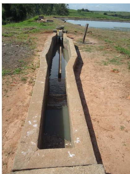
Foto 3.26 – Tratamento Preliminar e Calha Parshall – Entrada ETE
