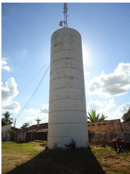
Foto 3.16 – Reservatório 01 (Sist. Prefeitura)
