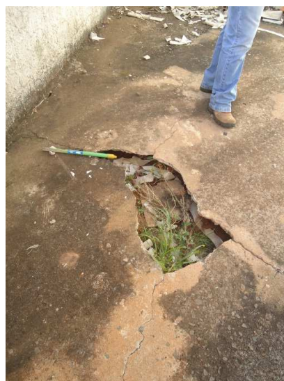
Foto 6.2 – R-06 – Infiltração no calçamento
