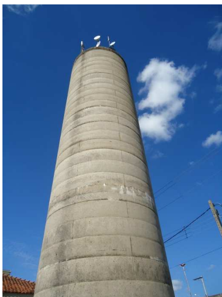
Foto 3.20 – Reservatório 05 (Sist. Velório)
