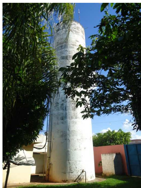
Foto 3.17 – Reservatório 02 (Sist. Centro de Lazer)
