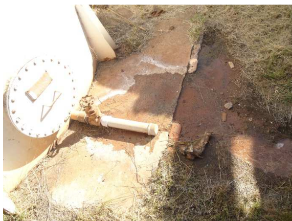
Foto 6.1 – R-01 – Vazamento no registro do ladrão
