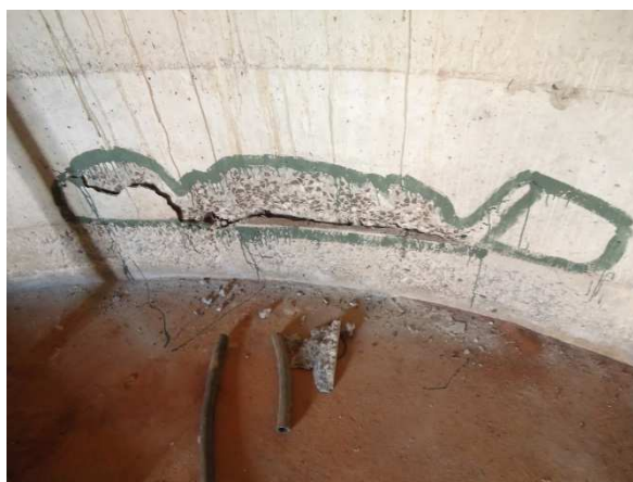
Foto 6.5 – R-06 – Problemas na estrutura do reservatório
