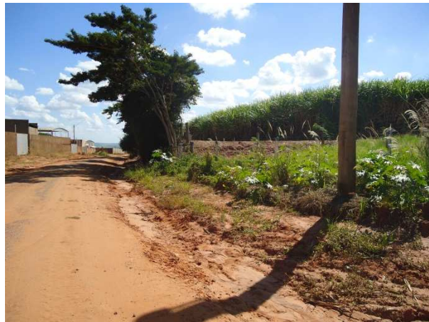
Foto 3.36 – Efeitos da falta de sarjeta
