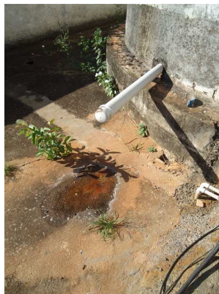
Foto 6.4 – R-06 – Vazamento no registro
